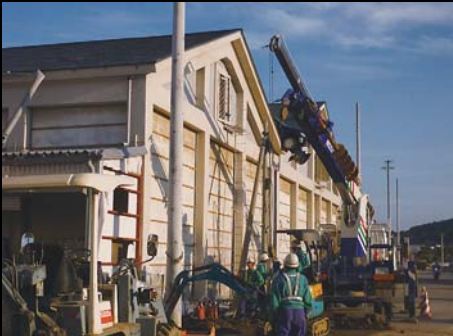
工場の屋根に打ち上げられた車を引き下ろしています。 7/28 撮影 総務課 今吉孝志
