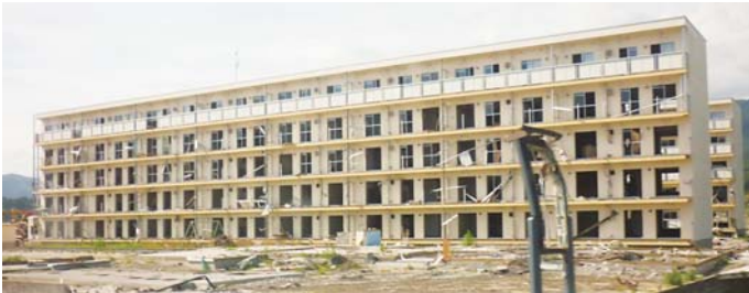
▲4階まで水に浸かったアパート
