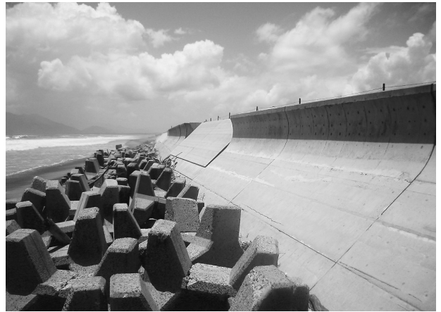
災害復旧工事後の状況
