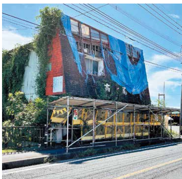
危険家屋(歩道側落下防止対策済)
