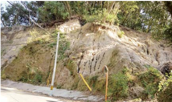
恒久対策が必要な法面
