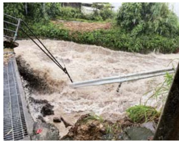
7月豪雨による堤防崩落
