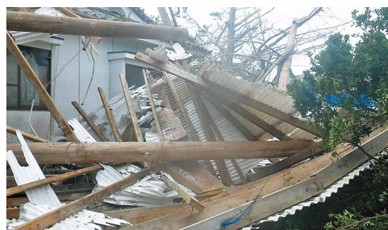
台風被害状況
